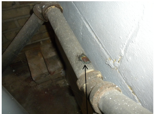
E1. Corroded drain pipe
